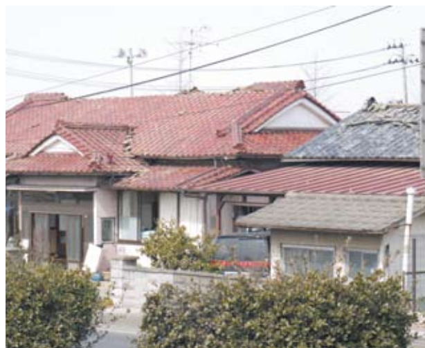
■ 瓦屋根の被害
