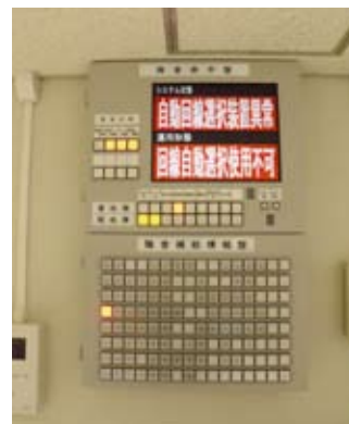
■総合防災情報システムの異常表示
